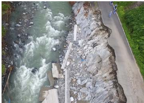
▲ ドローンを活用した被災状況調査
